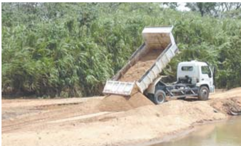
OBRA QUE PREVÊ o represamento do Rio Pequeno foi iniciada pelo SAAE
