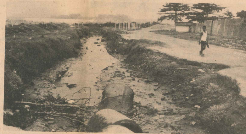
A vala de esgotos é um dos problemas na rua Dário Lourenço
