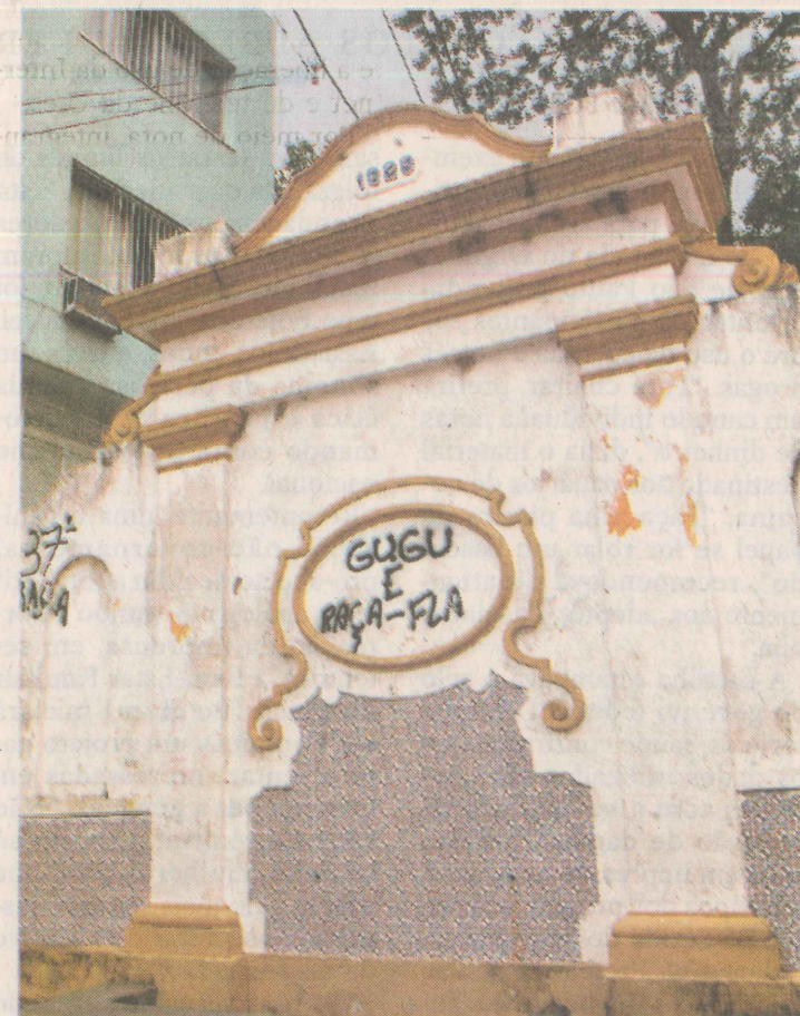
ALVO. Nem o pórtico de quase dois séculos de história, localizado na entrada do Parque Municipal da Gruta da Onça, localizado no Centro de Vitória, ficou livre das pichações promovidas por vândalos. Monumentos históricos e estátuas são alvo constantes de depredações nas cidades. FOTOS: CARLOS ALBERTO DA SILVA
