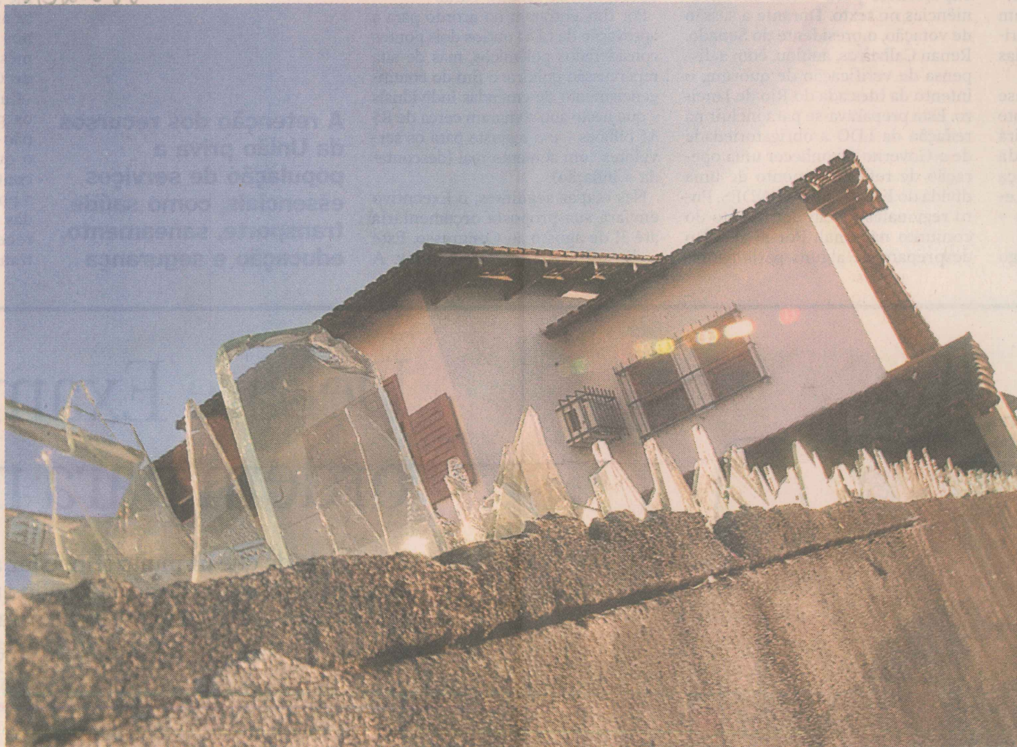
SOLUÇÃO. Moradores ainda recorrem à velha prática de colocar cacos de vidro no muro como medida preventiva FOTO: CARLOS ALBERTO DA SILVA
