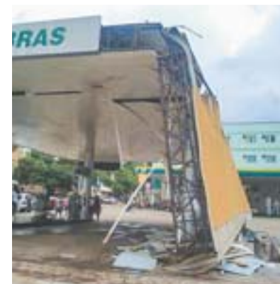
POSTO: estrutura metálica destruída
