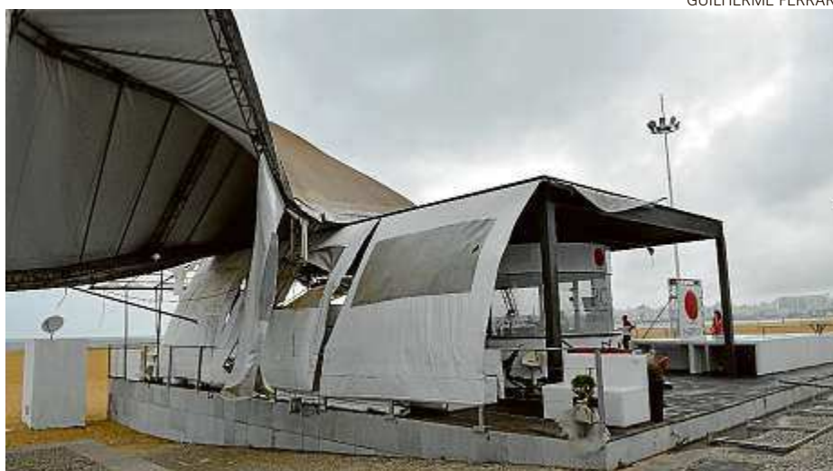
Estrutura desabou cerca de uma hora antes de o restaurante abrir ao público
