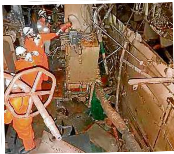
Profissionais avaliam a destruição na plataforma
