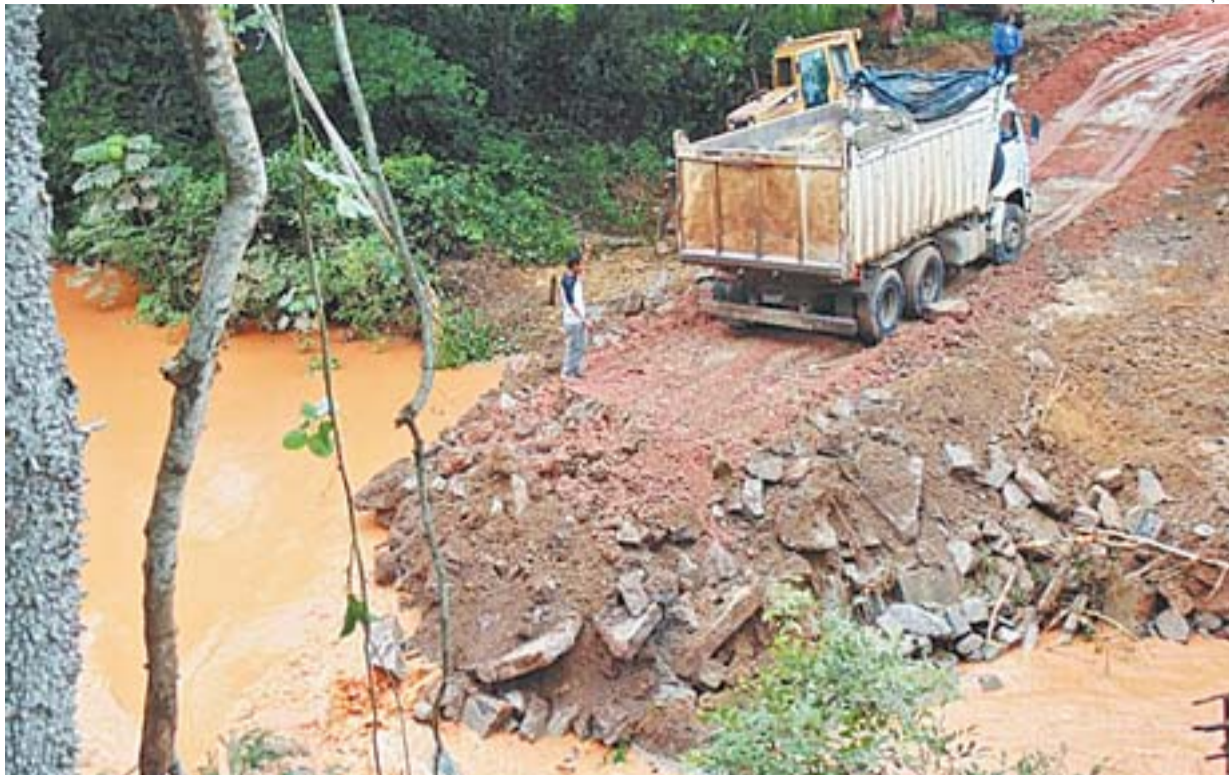
OPERÁRIOS trabalham no reforço de barragem em Linhares para conter invasão de lama de rejeitos na Lagoa Nova
