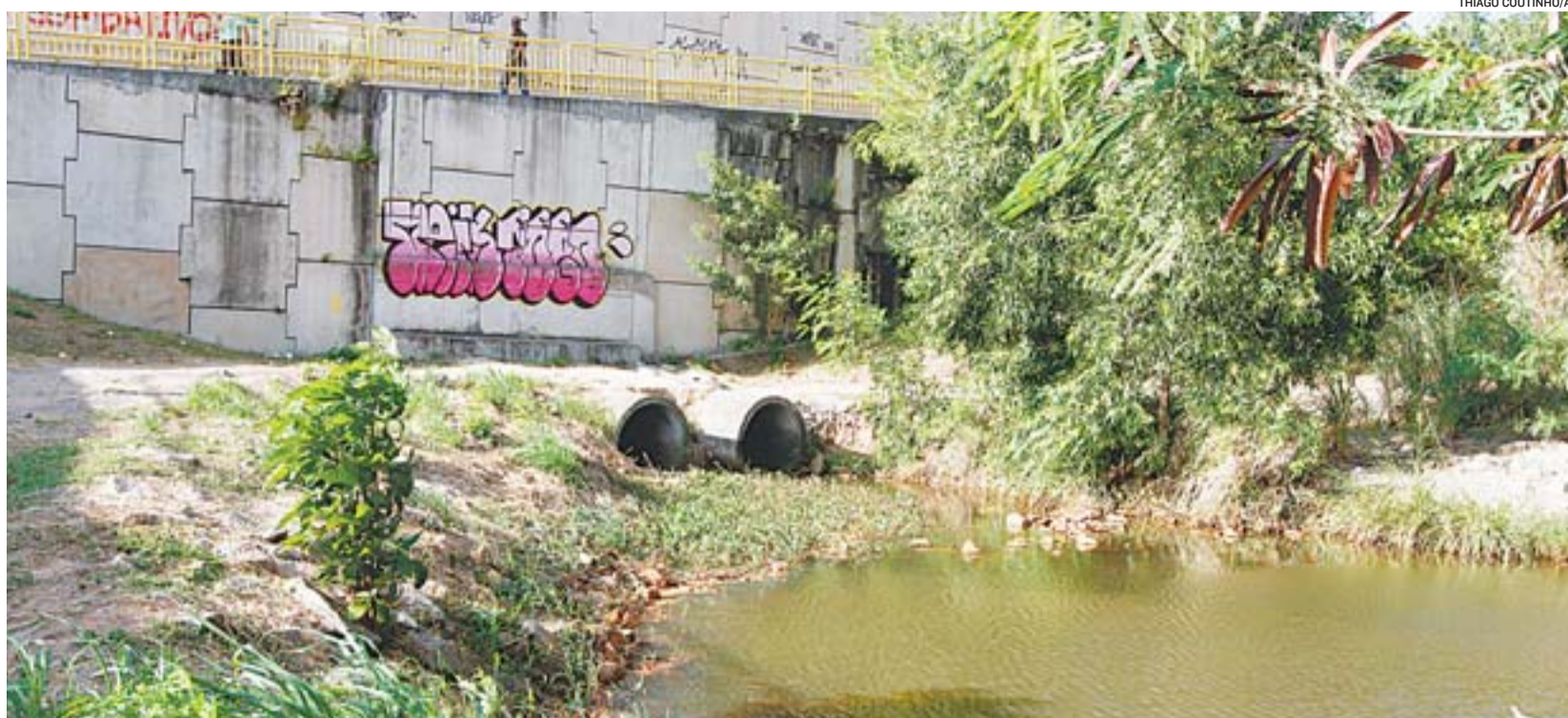
ESGOTO SEM TRATAMENTO lançado na orla de Camburi: proprietários de imóveis estão sendo notificados para que façam a ligação à rede da Cesan
