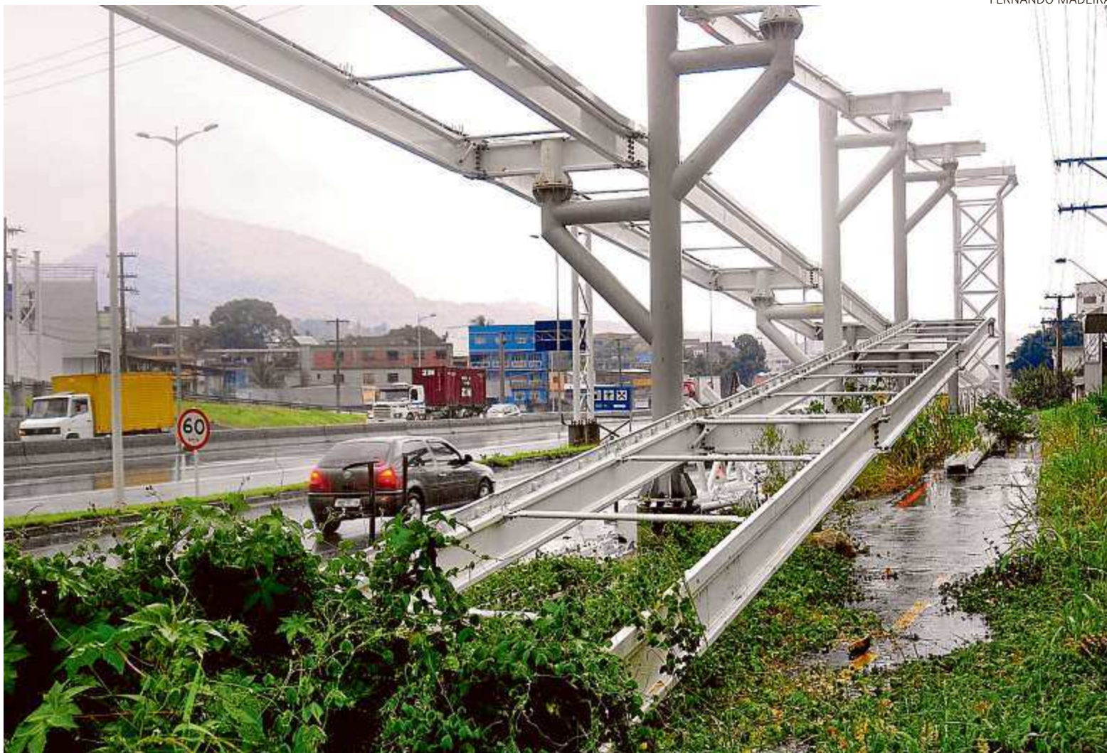
Passarela abandonada na Rodovia do Contorno, na altura do bairro Vila Progresso, em Cariacica. Estrutura é prejudicada pelo tempo
