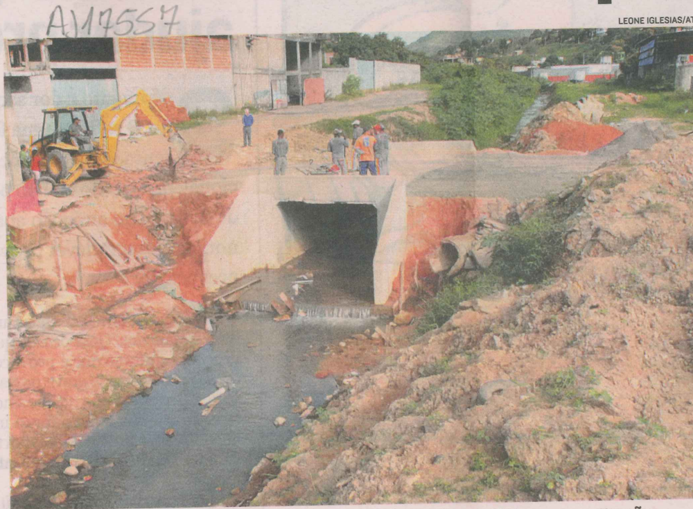
PONTE que vai ligar Arlindo Vilaschi I ao bairro Vila Bethânia, em Viana, em construção
