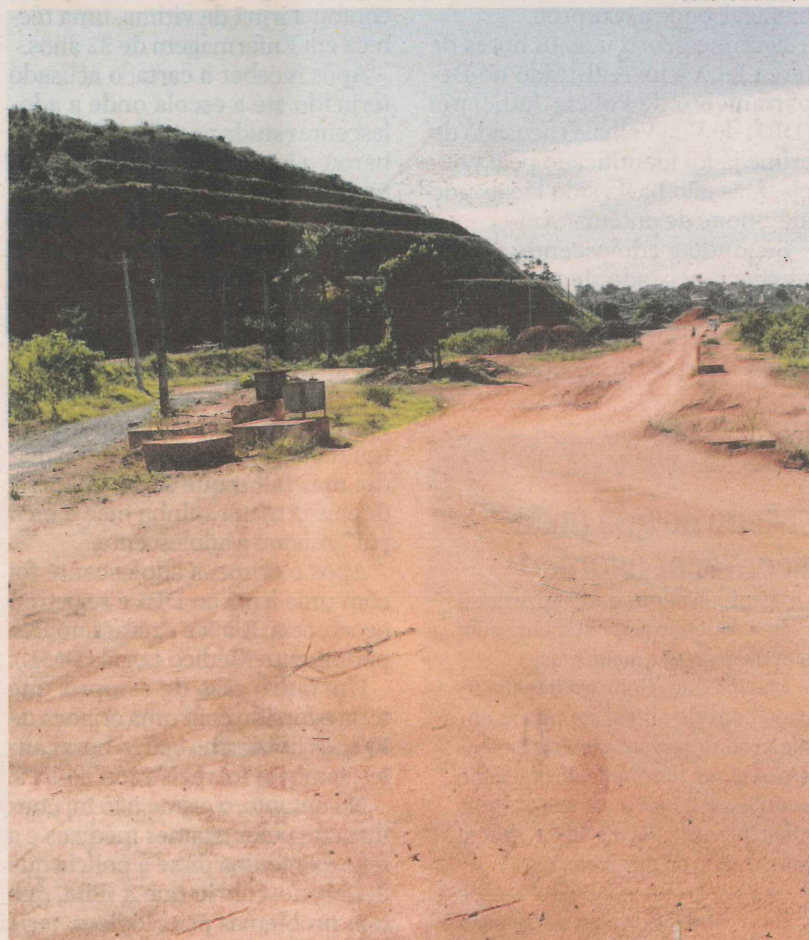
ANTIGA rua Jaqueira, onde obras foram iniciadas e depois paralisadas
