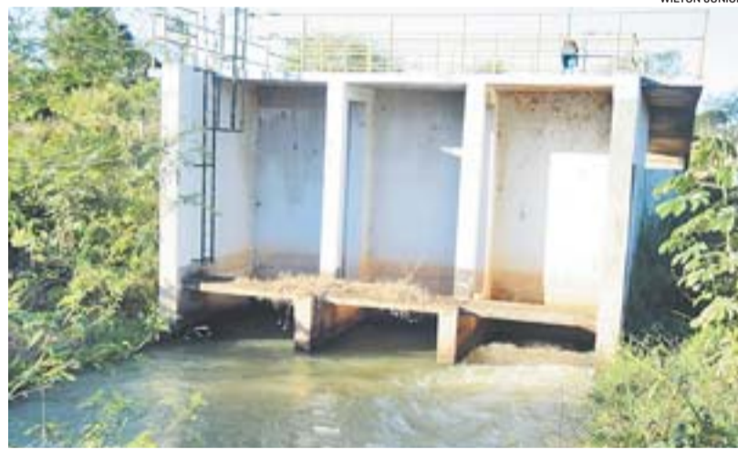
COMPORTA do Canal Caboclo Bernardo pode ter de ser fechada
