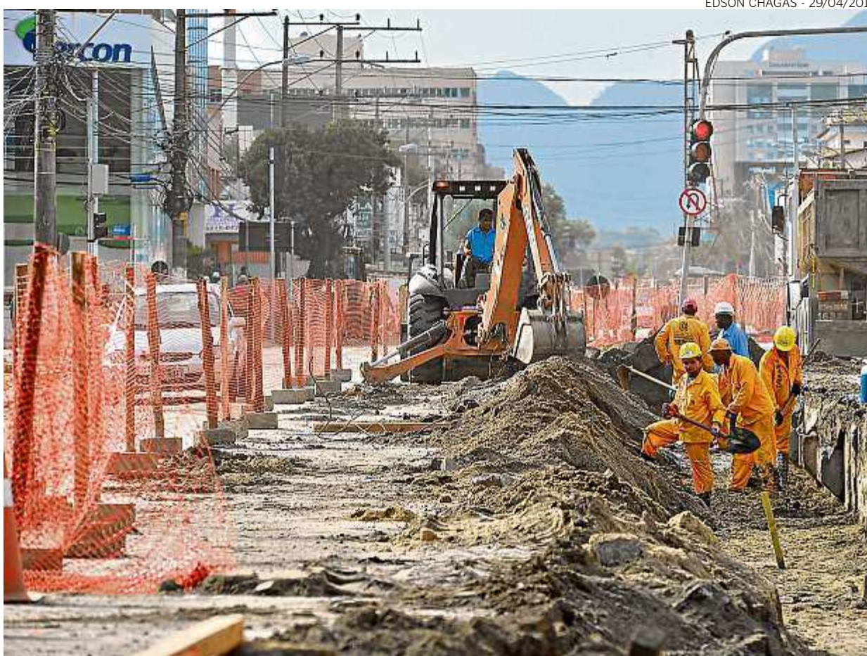
O atraso para a conclusão da obra na avenida ocorreu devido à falta de planejamento antes da licitação
