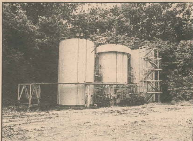
As águas pluviais de toda a área de Tubarão seguem até a praia, onde são recolhidas pelos tanques de homogeneização e devolvidas, por bombeamento, aos tanques de decantação. Estes recebem também as águas industriais para decantação e posterior correção de PH
