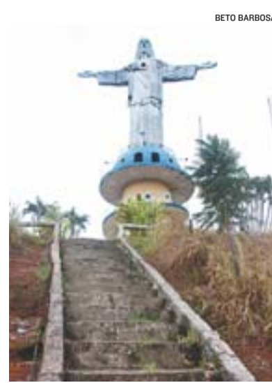
CRISTO: falta de manutenção
