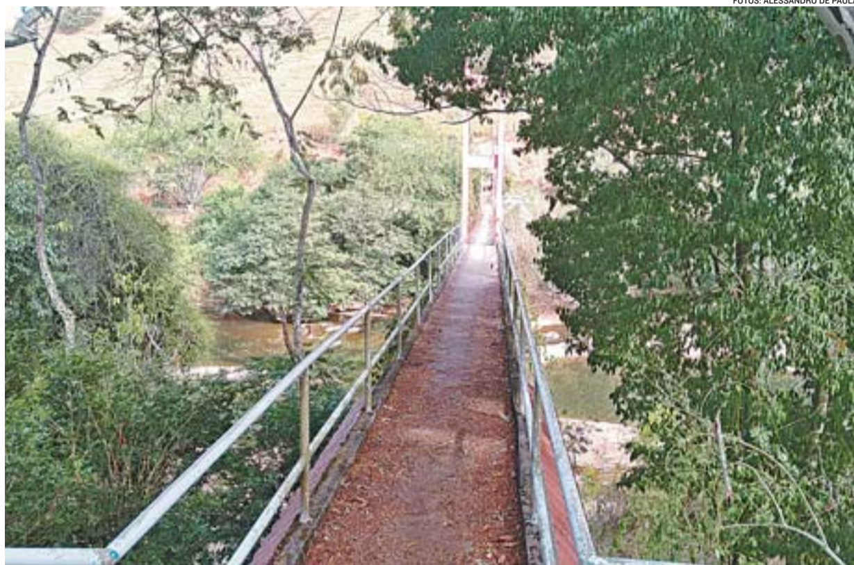
ATRAVESSAR a ponte que une a Ilha dos Meirelles a Cachoeiro é um perigo: ripas estão podres e faltam tábuas
