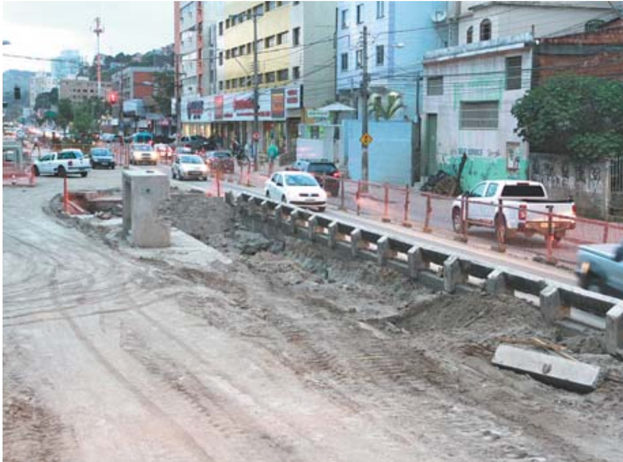
TRECHO EM OBRAS na avenida Leitão da Silva: DER diz que dentro de três meses problema deve ser reduzido
