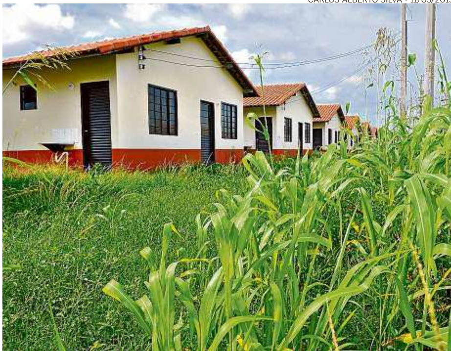
Com atraso, casas do Residencial Rio Doce, em Linhares, estão tomadas pelo mato
