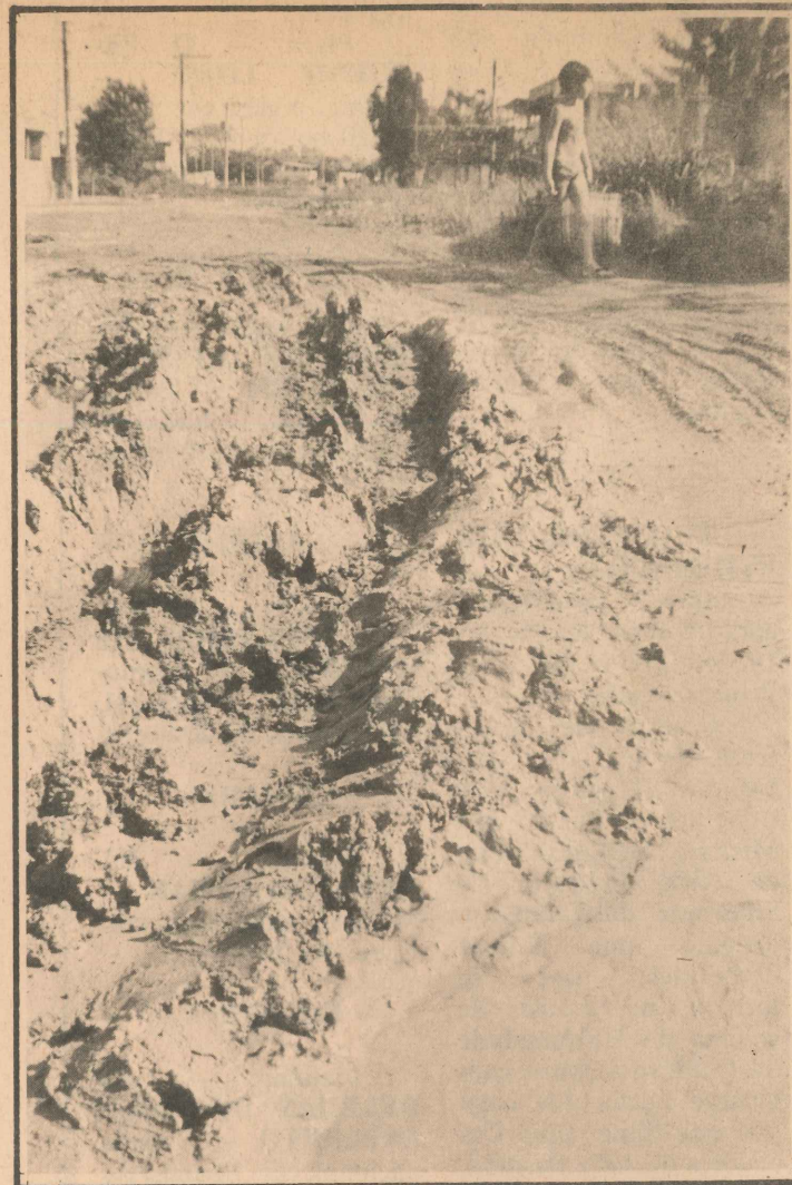
A maioria das ruas está em péssima situação
