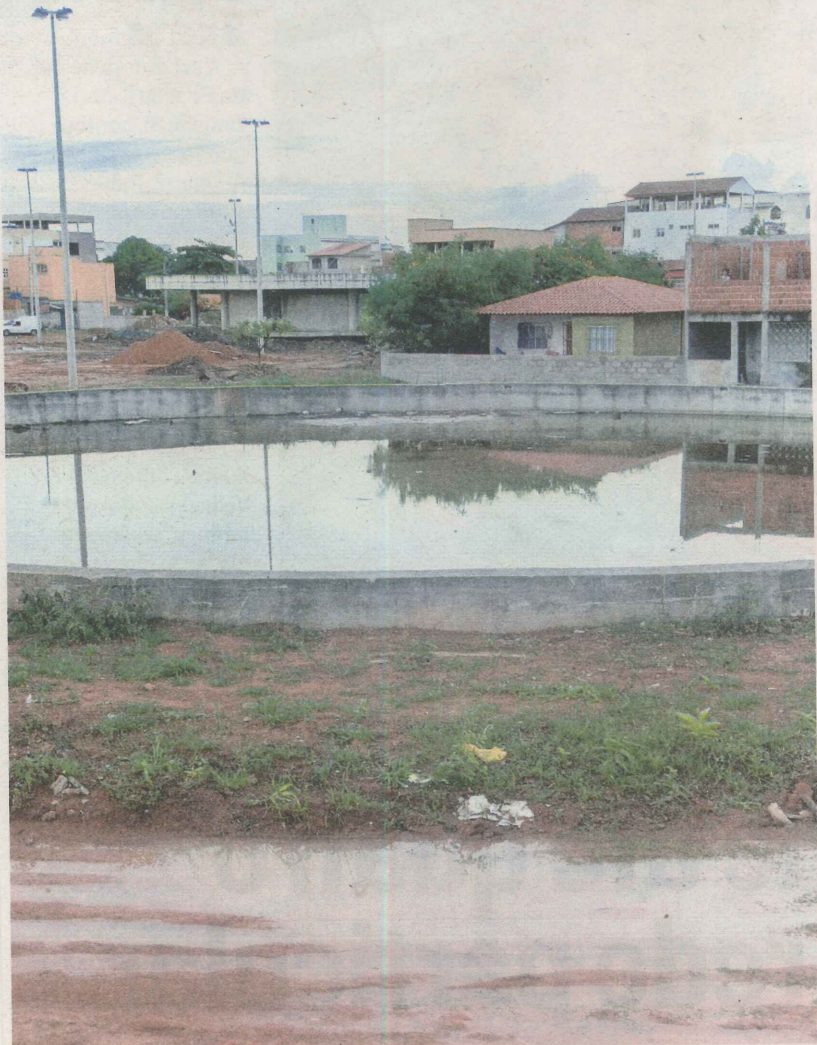
LAGO construído em área que deveria abrigar parque municipal: obra parada
