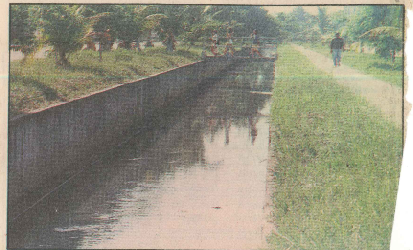
A grande vala foi canalizada mas atrapalha e gera pernilongos
