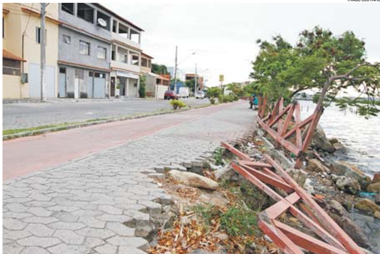
TRECHO de orla que desmoronou entre os bairros Santo Antônio e Inhanguetá e que precisa de reparos
