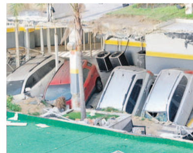
VEÍCULOS sob os escombros
