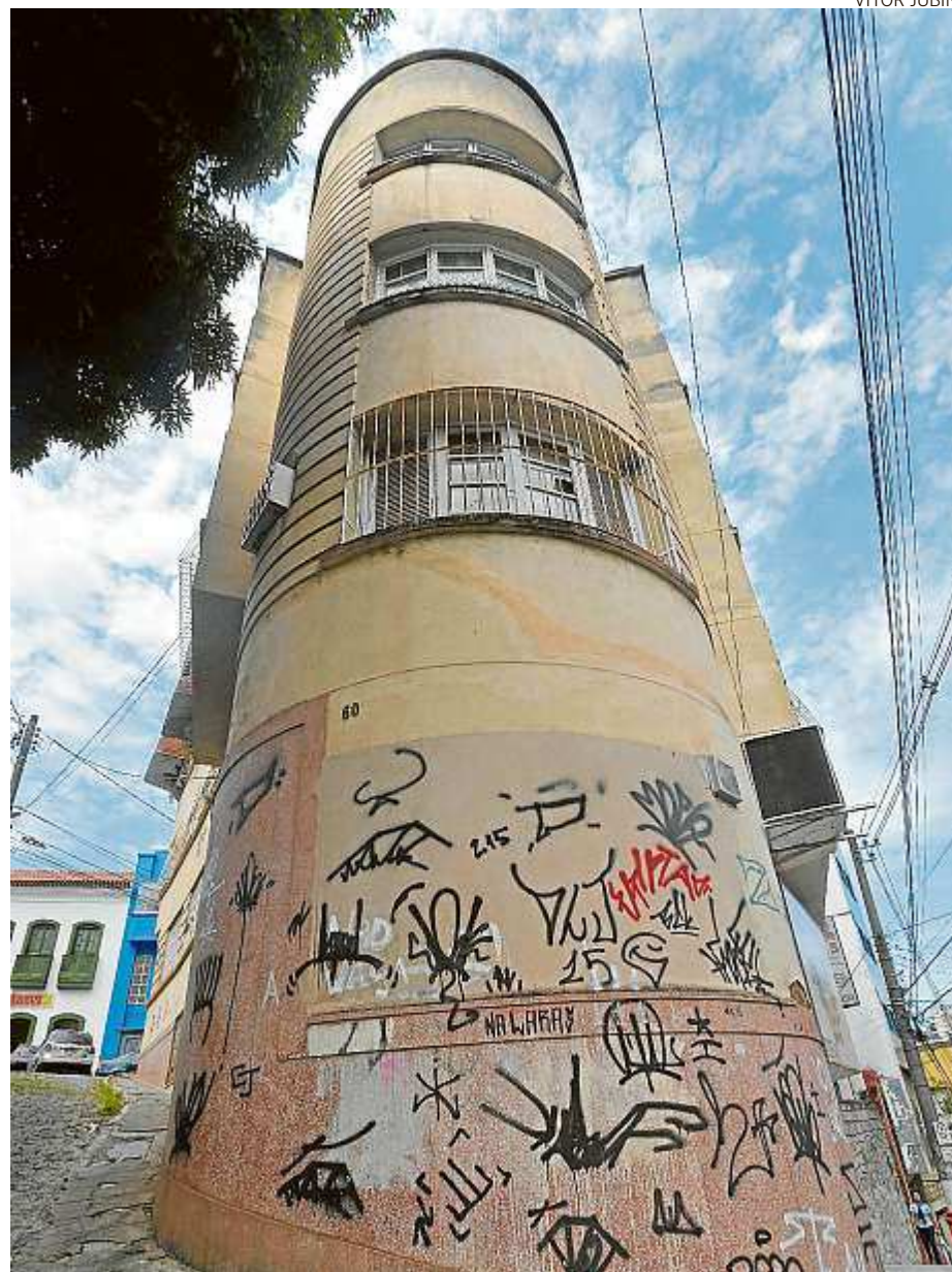
Prédio na Rua Dionísio Rosendo, no Centro da Capital, marcado por pichação
