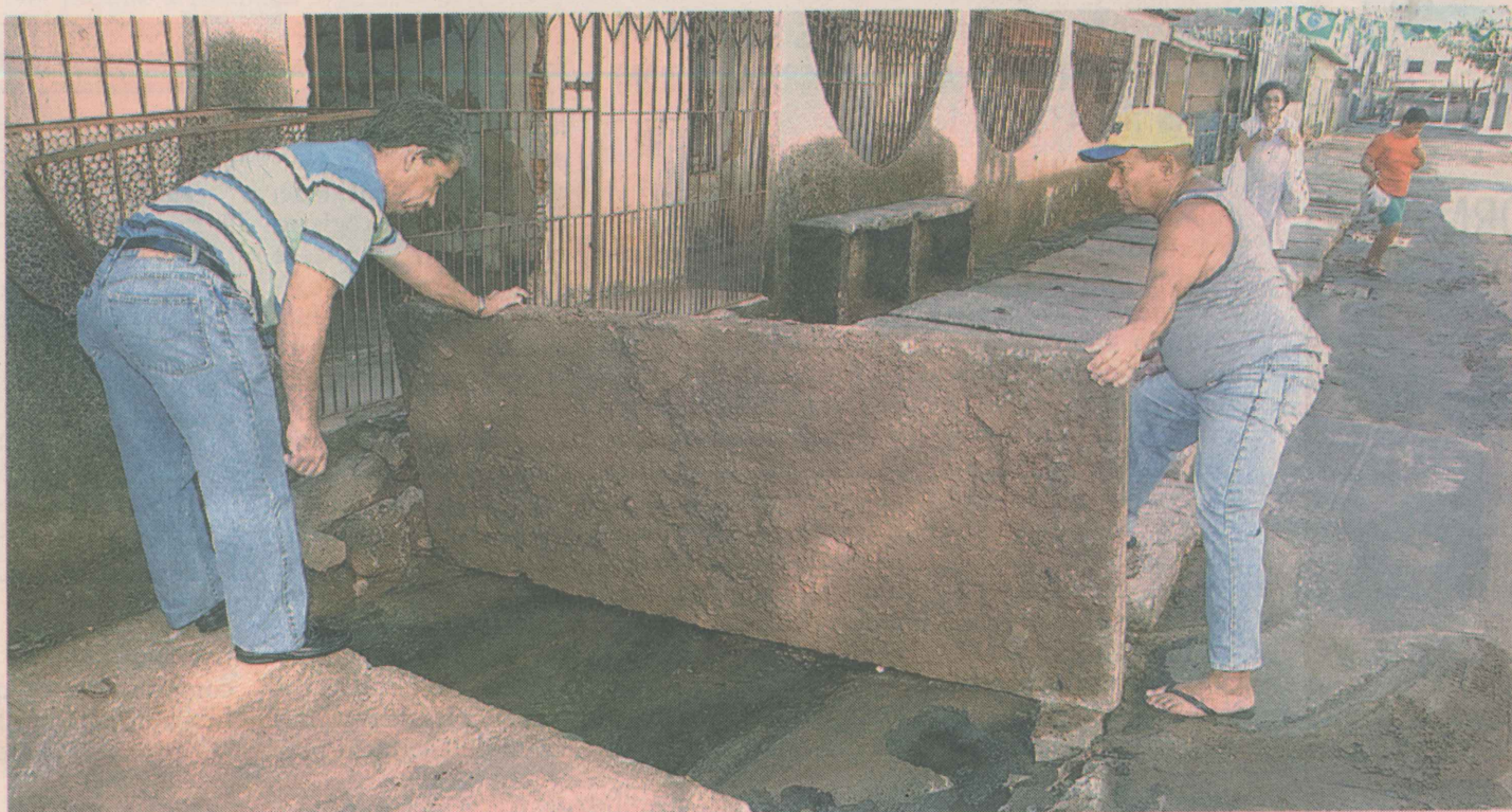
SEM ESCOAMENTO. Assoreamento das galerias pluviais provoca inundação em ruas do bairro, quando chove forte. Prova são marcas de enchentes nos muros de várias casas. FOTO: FÁBIO VICENTINI
