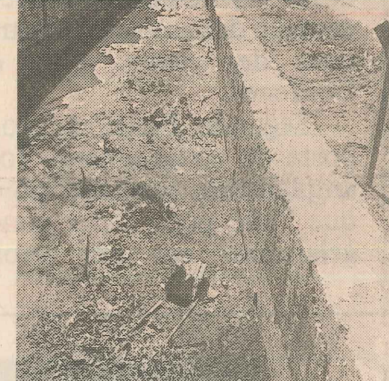
O esgoto corre a céu aberto
