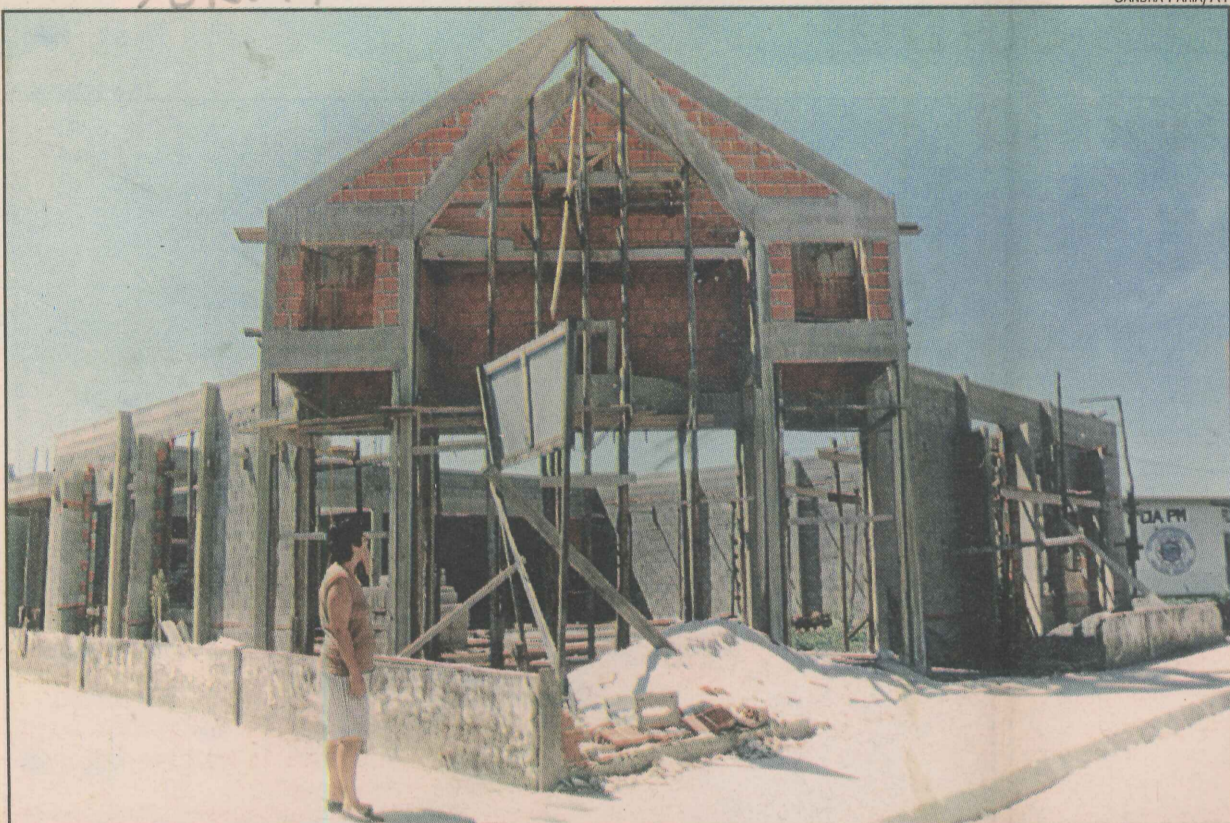
As obras da igreja começaram no ano passado com a colaboração da comunidade
