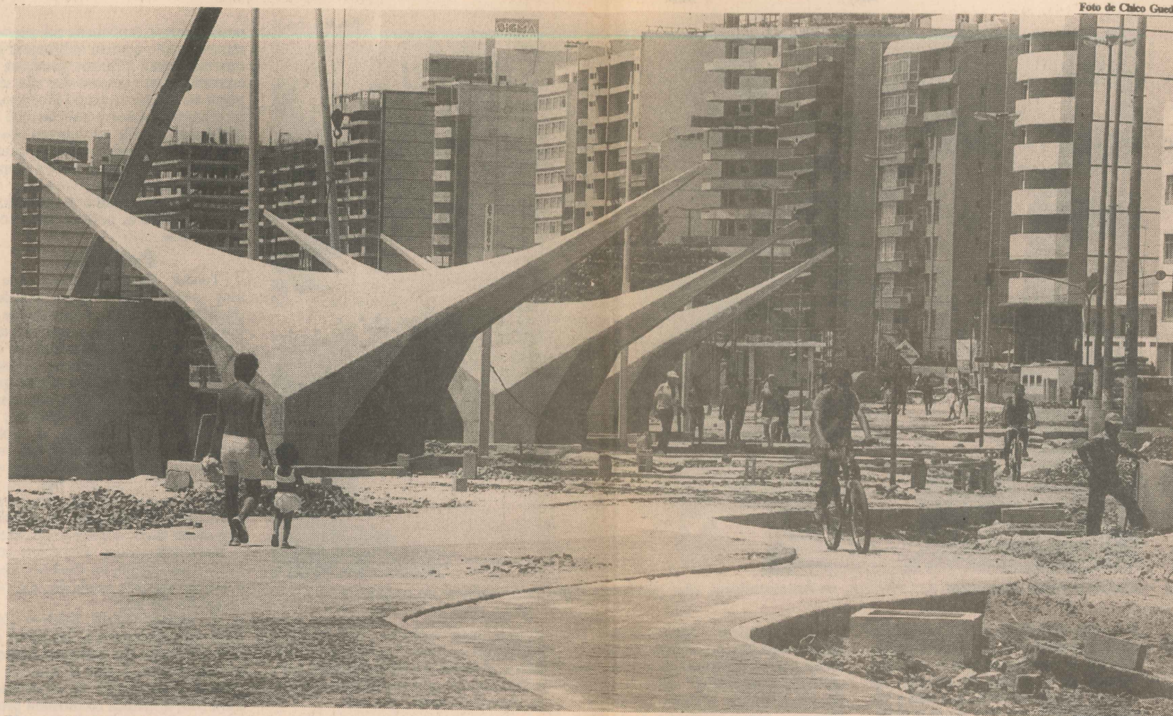
Uma série de problemas, que vão desde a parte estética à qualidade dos serviços, envolve a obra de urbanização da Praia da Costa
