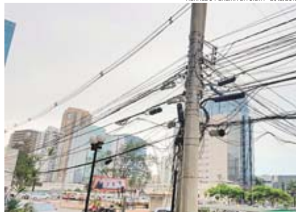
FIOS EM POSTE na Enseada do Suá: concessionárias terão 2 anos para fazer instalação subterrânea em frente a prédios históricos
