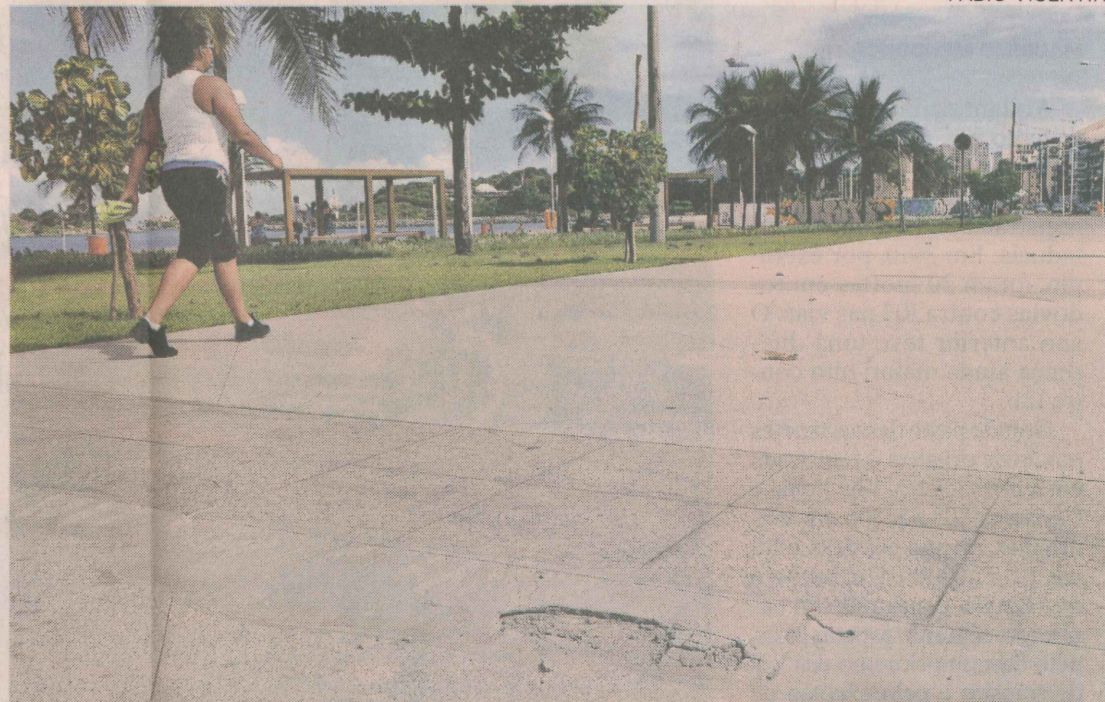
ALTERNATIVA. Quem passa pelo local depara com reparos emergenciais, feitos para evitar acidentes
