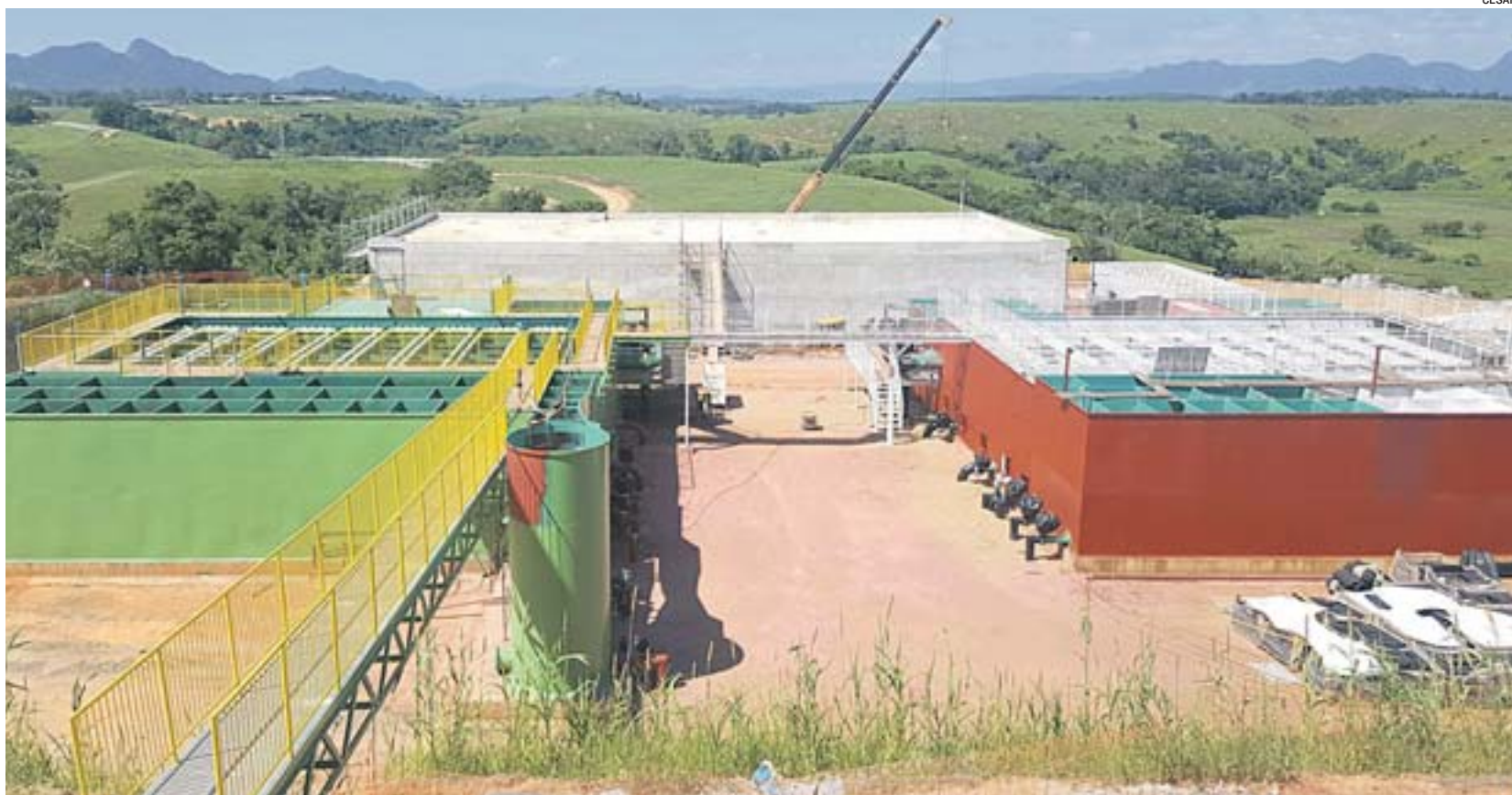
SISTEMA de abastecimento Reis Magos terá adutora e elevatória de água bruta, estação de tratamento e reservatório de água tratada de 5 milhões de litros
