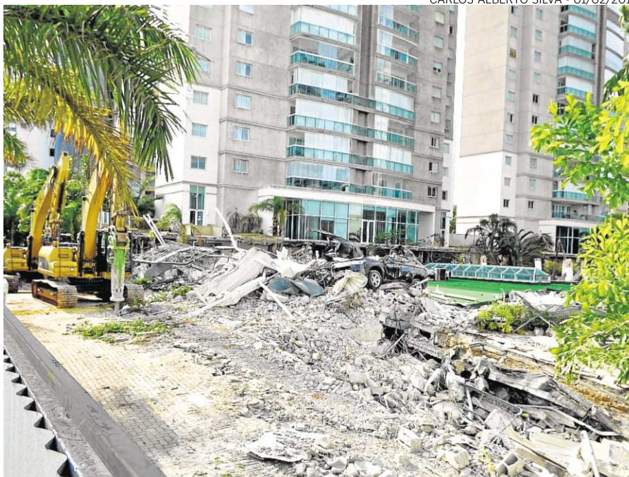
Máquina retira carro dos escombros do Grand Parc, que desabou no ano passado
