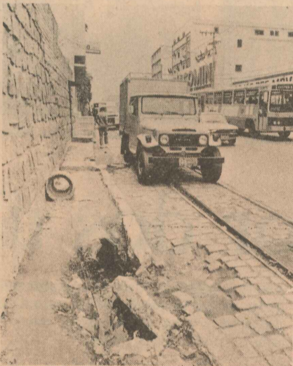
Av. Alexandre Buaiz: esgoto
