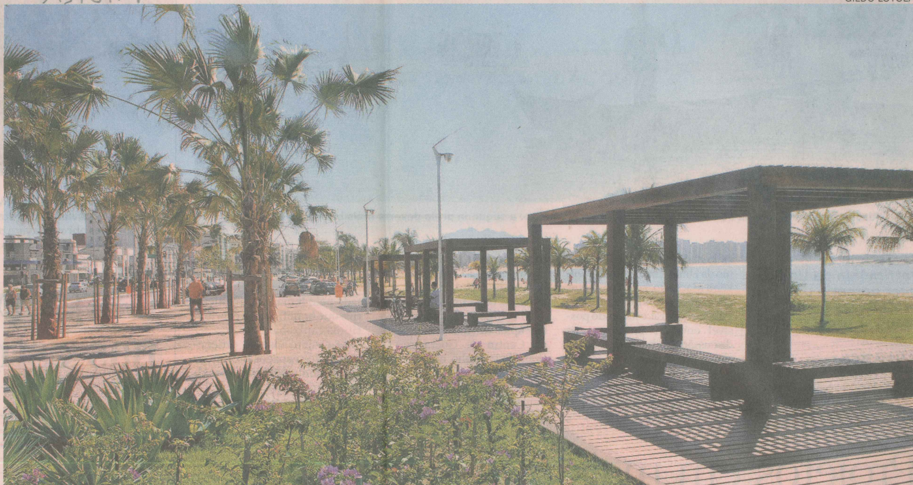
ENTREGUE. Primeira etapa da obra de Camburi já está pronta, com estacionamento, calçadão, estruturas de madeira e paisagismo
