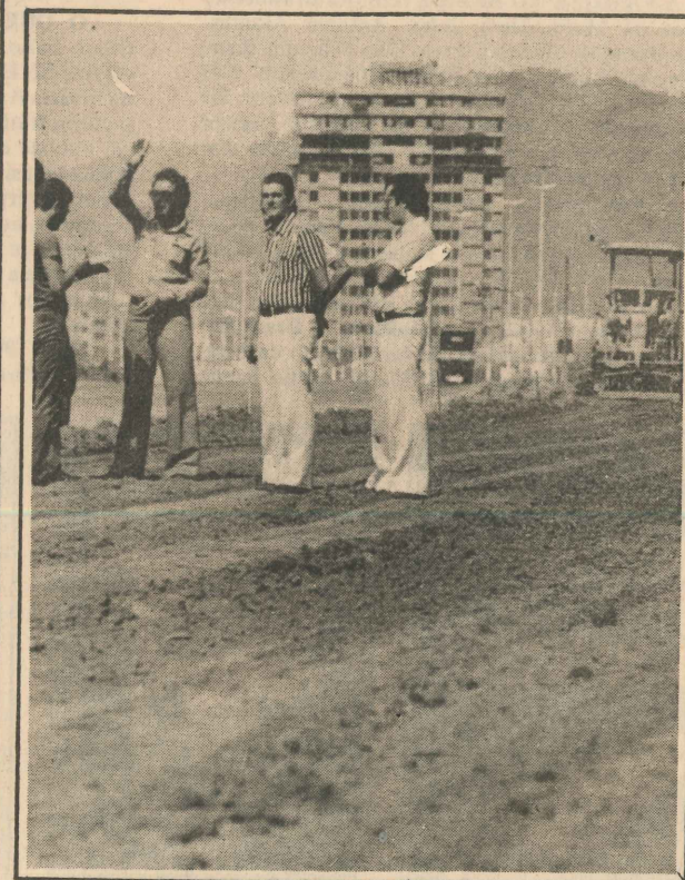
O asfalto foi construído em cima da areia para atender às imobiliárias
