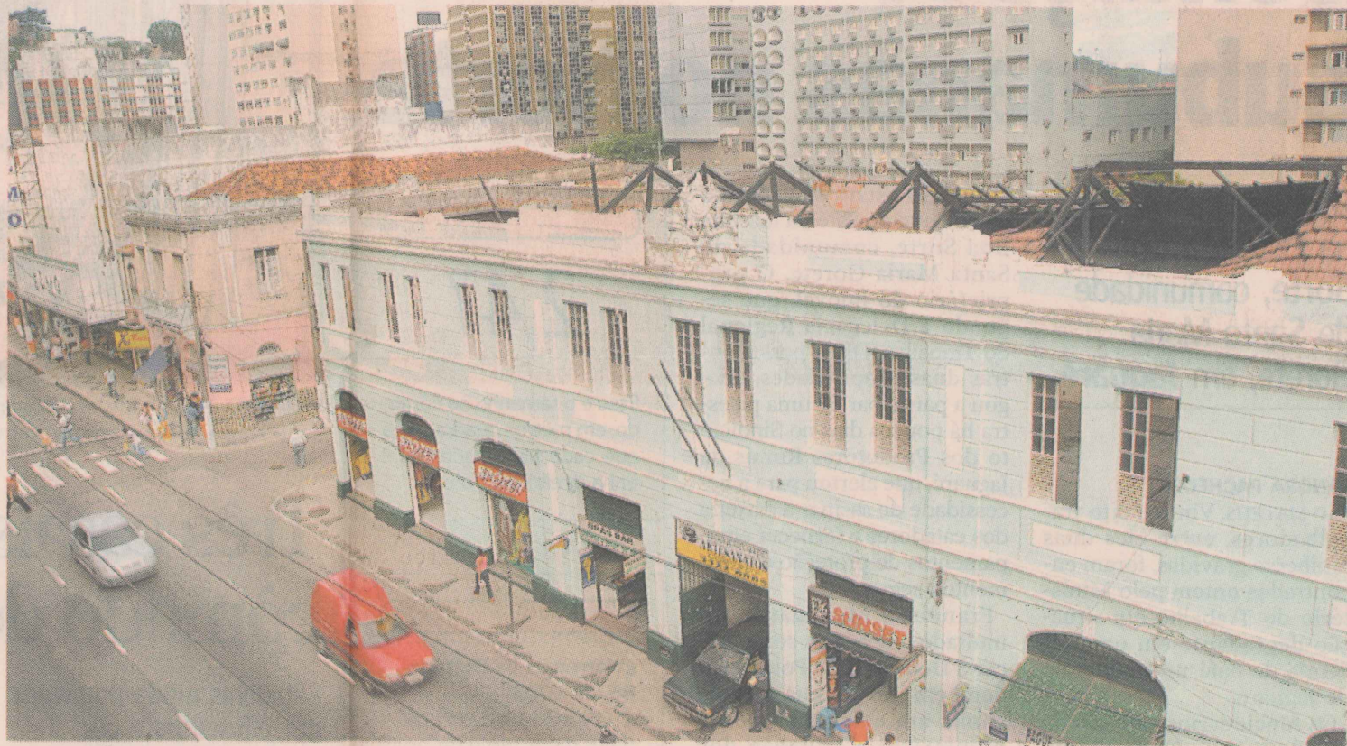
CONSTRUÇÃO. O telhado do mercado será restaurado, mas ainda não há outro projeto de melhorias para o local. FOTO: EDSON CHAGAS
