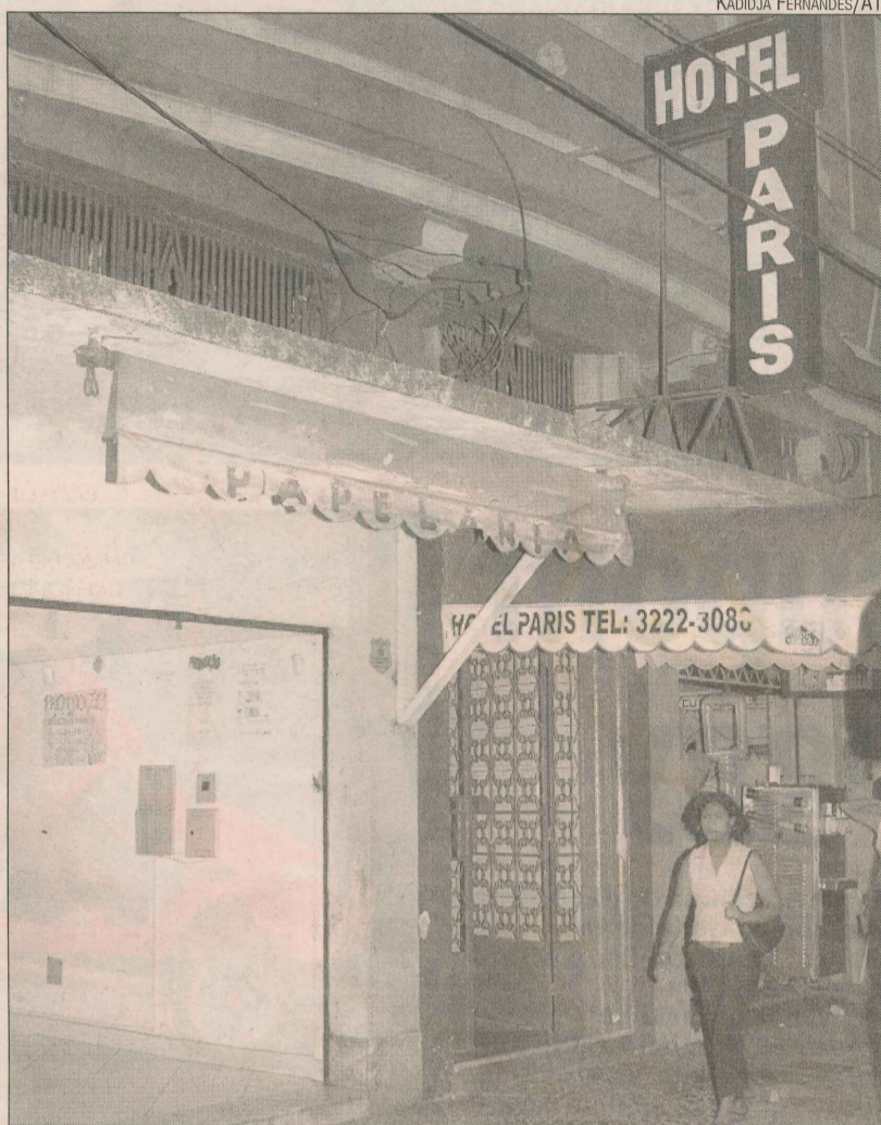
Marquise na General Osório que terá de ser demolida
