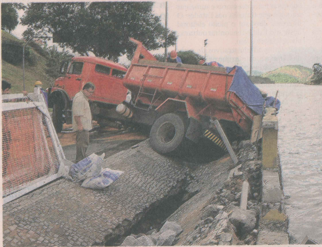
QUEBRADEIRA. O caminhão iria descarregar terra para a obra de reforma na avenida quando tombou
