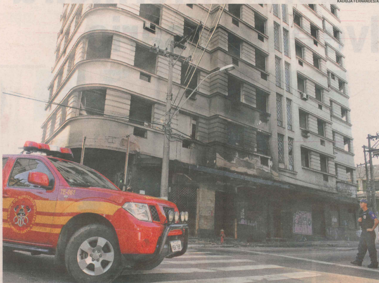
ANTIGO PRÉDIO do INSS foi atingido por fogo no primeiro andar. O edifício está desocupado
