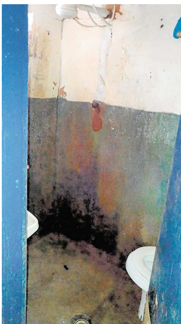
Banheiro usado por trabalhadores trazidos da Bahia
