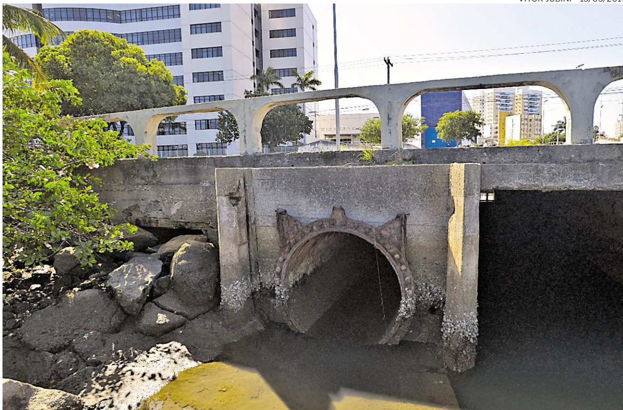
Flagrante de esgoto localizado no bairro Bento Ferreira sendo jogado diretamente na baía de Vitória
