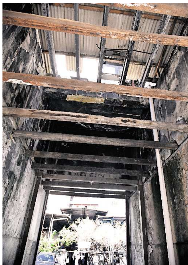
Telhado do segundo pavimento está prejudicado
