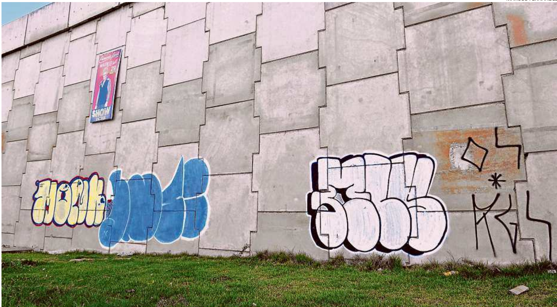
Viaduto da BR 101, em frente à Ceasa, em Cariacica, foi entregue no final do ano passado e já se tornou um dos mais novos alvos de pichadores da Grande Vitória
