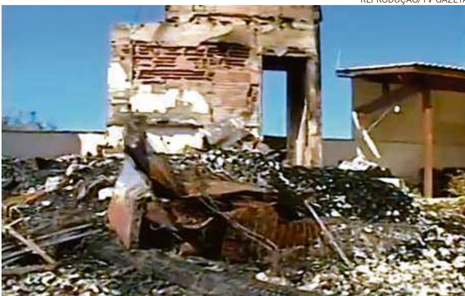
Meses depois, a mesma residência foi completamente destruída por incêndio
