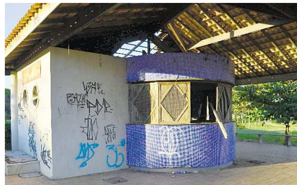
Kiosque não usado no final da orla está depredado
